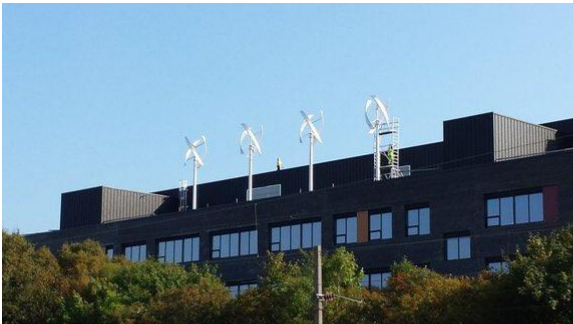
Figur 6-1 Bilde er av vindturbinene montert på taket til Bryne VGS. Kilde: https://twitter.com/Hakonrl/status/1112692515952607233
